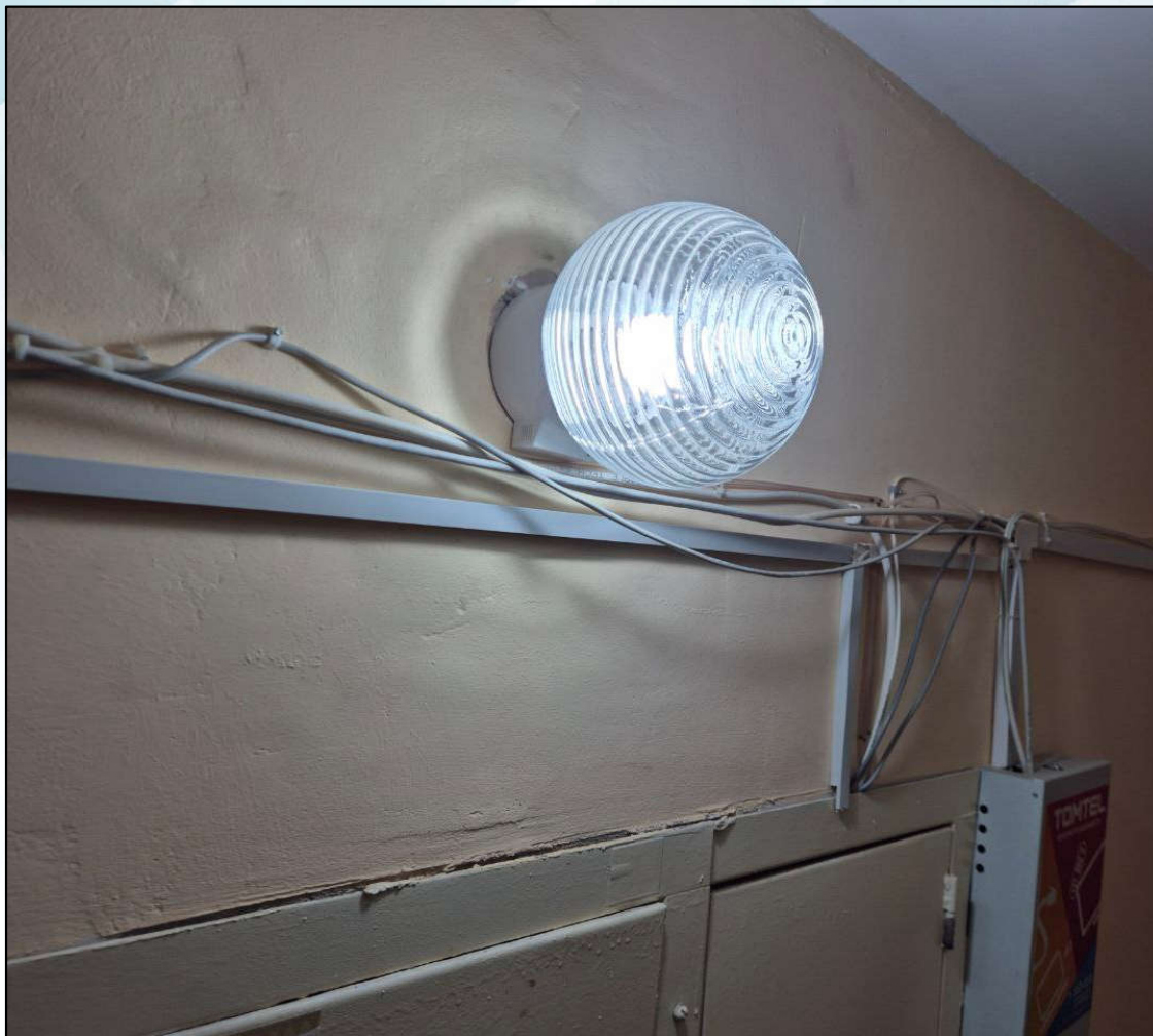
Новый светильник в 1-м подъезде
