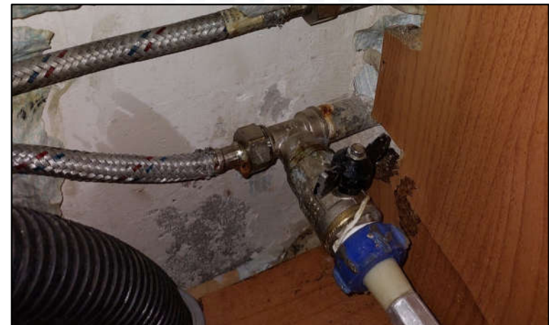
Вышедшая из строя гибкая подводка
