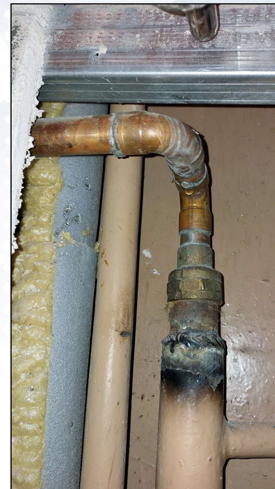
Заужение стояка ГВС
