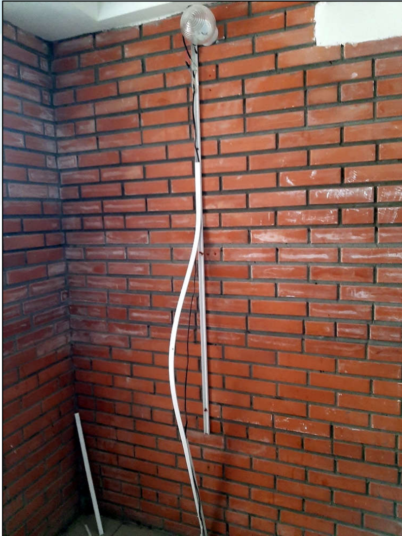
Испорченные кабель-каналы в 1-м подъезде наркоманом
