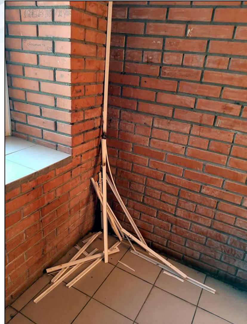
Испорченные кабель-каналы в 3-м подъезде жильцами и «гостями»
